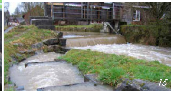
Bereits beim Bau des Hochwasser-Entlastungskanals wurde die Baustelle und wegen noch nicht fertiger Trennwand die Hegmatte im Juni 2016 überflutet (14).
