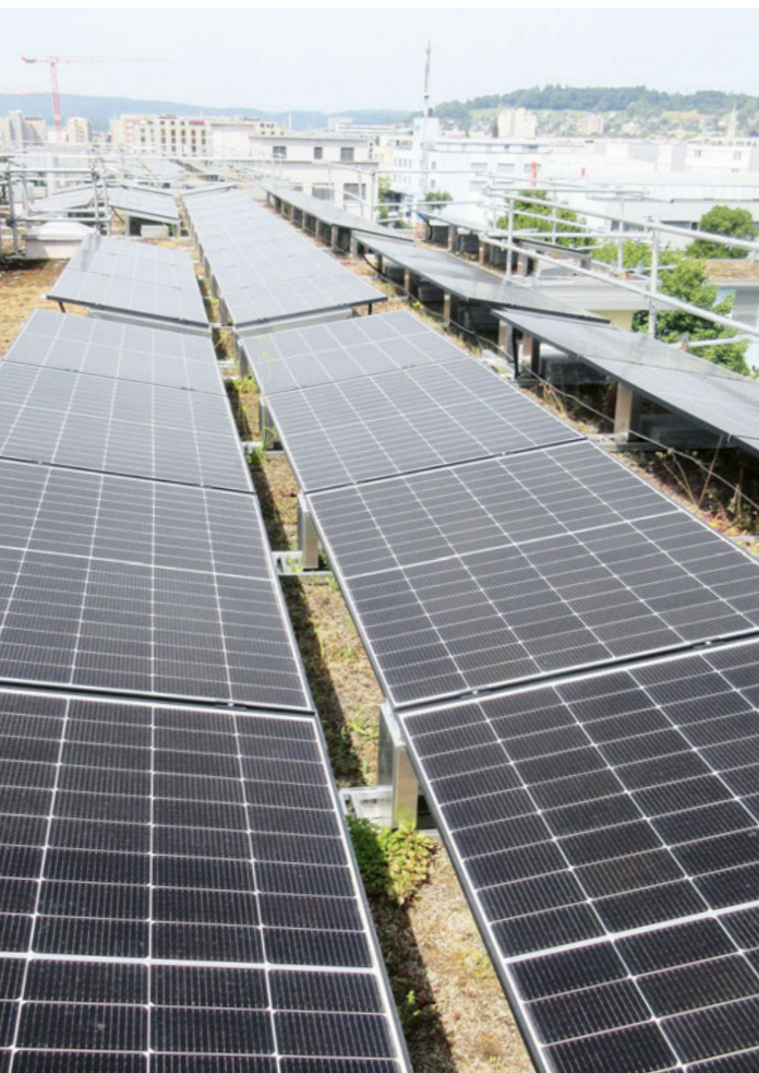
Die neue PV-Anlage auf einem Gebäude des Wohnparks Hintermühlen
